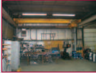
3 TON BRIDGE CRANE
