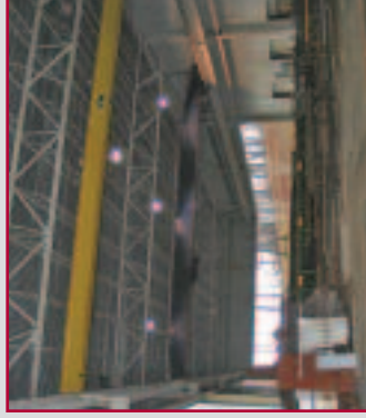
STAHL 10 TON BRIDGE CRANE
